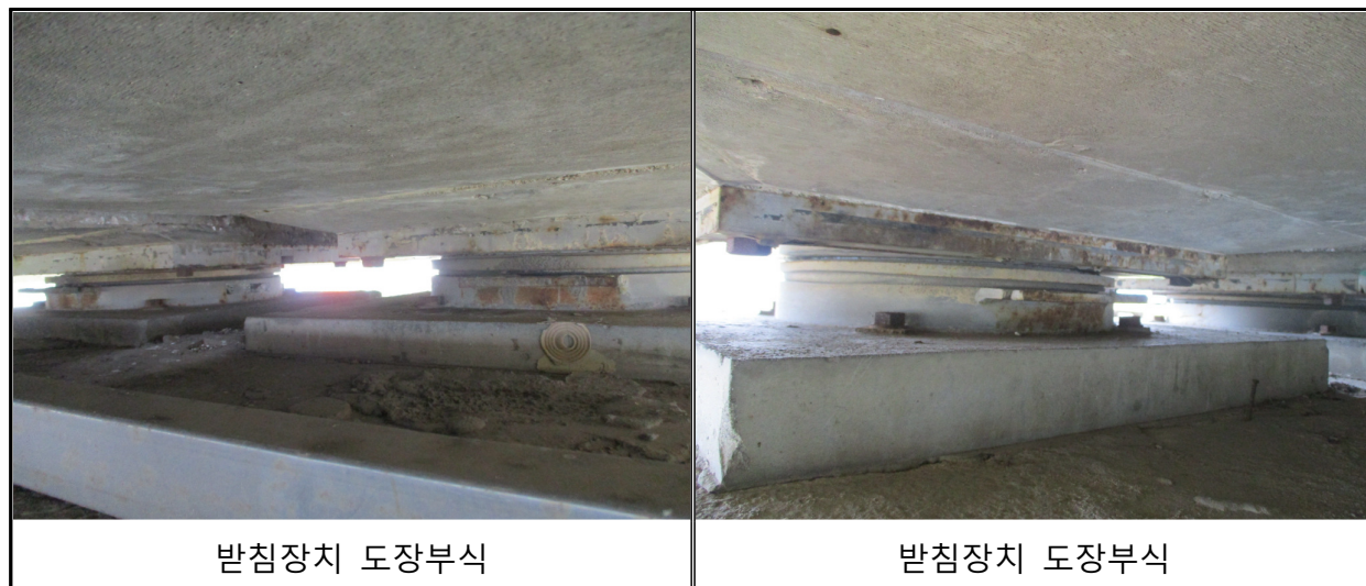
<사진 3.8> 교량받침의 결함 및 손상현황
