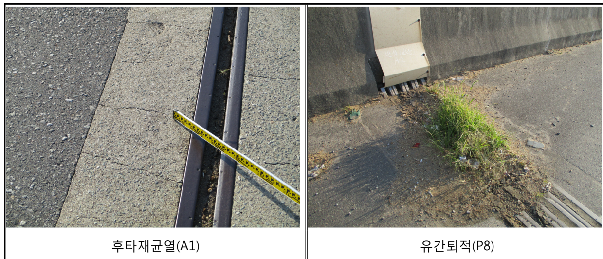
&lt;사진 3.4&gt;신축이음의 결함 및 손상현황
