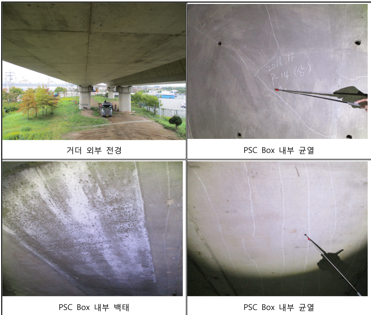
<사진 3.7> 거더 내·외부 결함 및 손상현황
