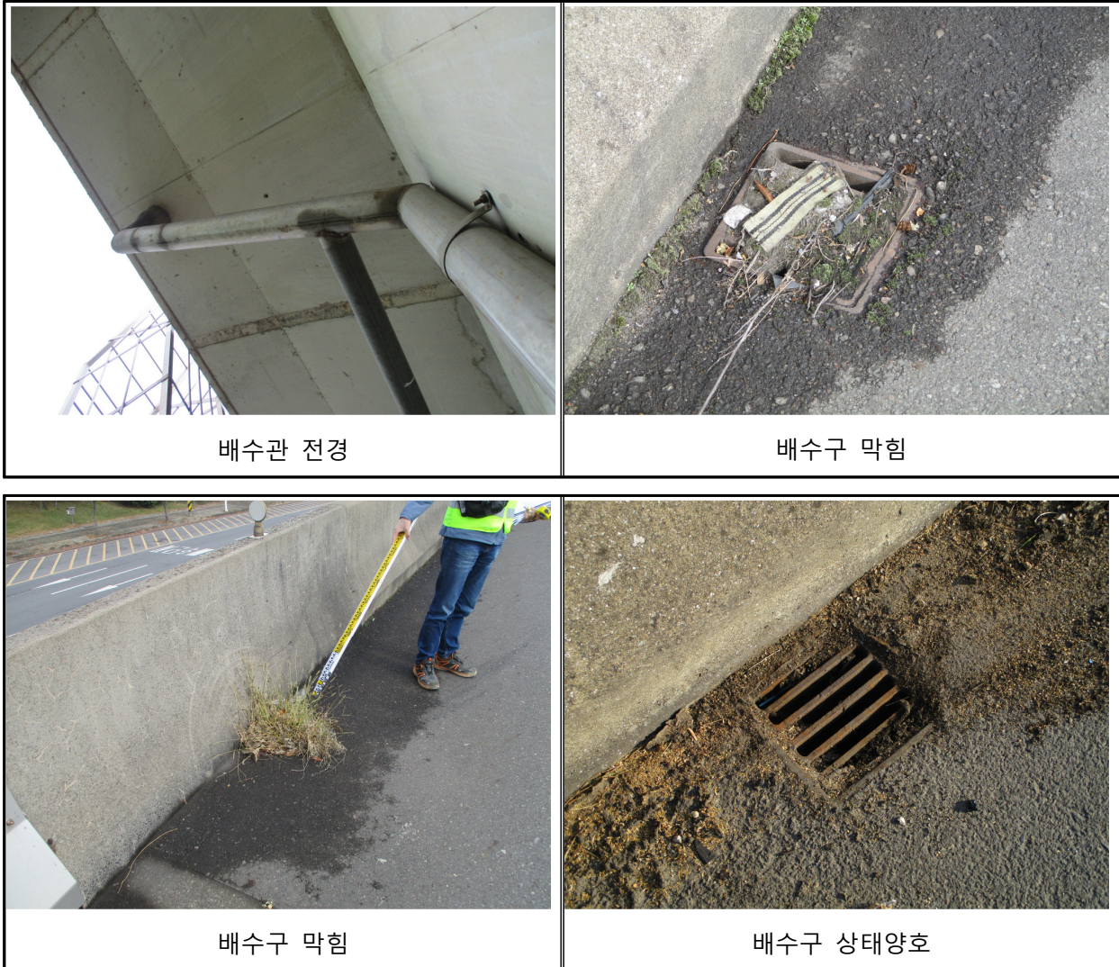
<사진 3.3> 배수시설의 결함 및 손상현황
